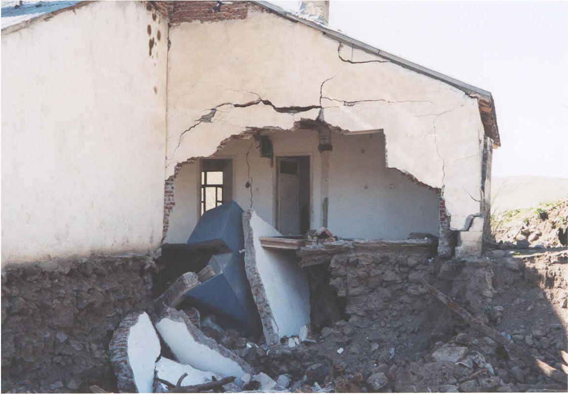
Şekil 5: Gevşek zeminli ve duvar altı hatılsız bina
