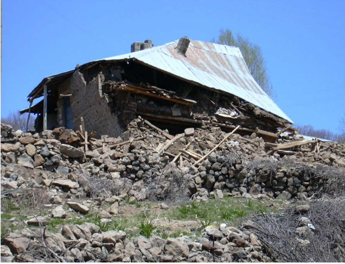
Şekil 4: Zayıf ve gevşek köşe bağlantılı bina
